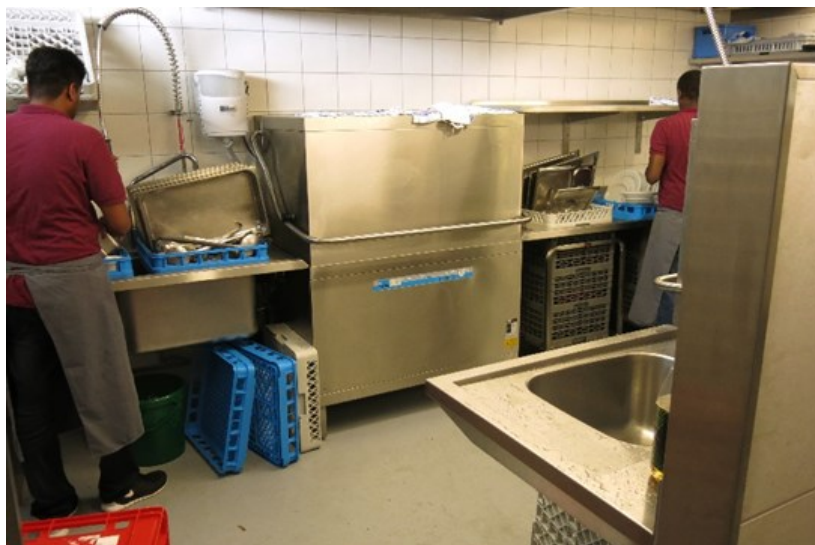
Die vergrösserte Abwaschküche (hier die neue mit Doppel-Geschirrwash-anlage) ermöglicht deutlich verbesserte Arbeitsbedingungen und einen optimierten Materialfluss.
